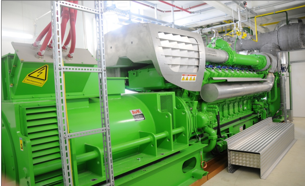
BHKW-Modul kurz vor der Inbetriebnahme
