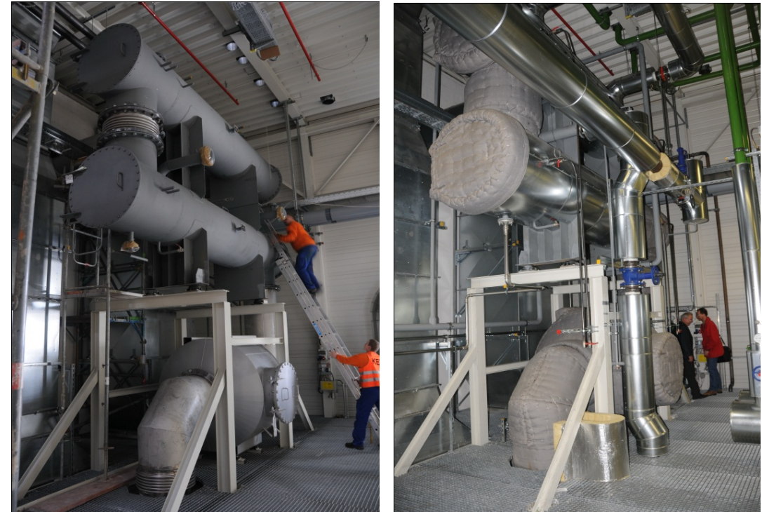
Abgasstrang mit Katalysator, Abgaswärmetauscher und 2. Abgaswärmetauscher (Brennwertabgaswärmetauscher)
