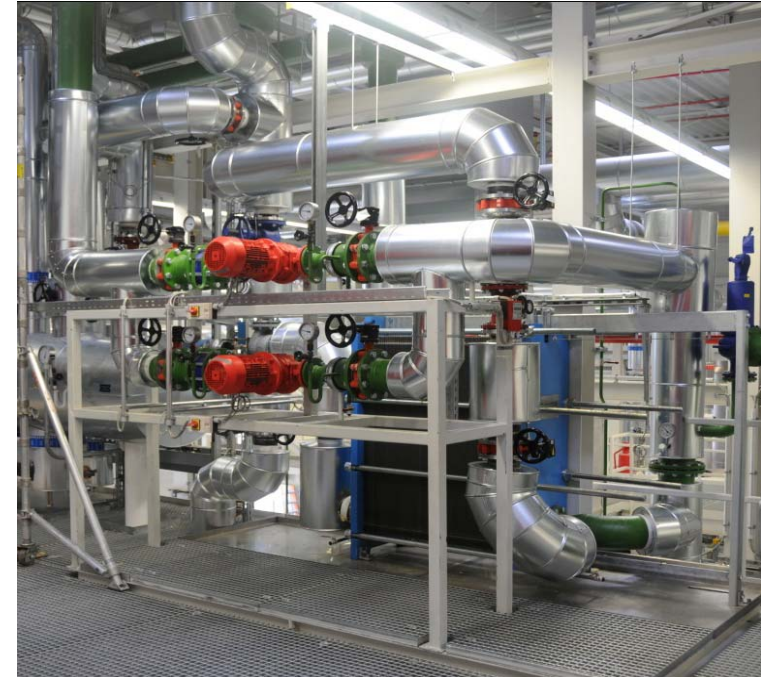
Wärmetauscherblock mit Pumpengruppe für die Notkühlung
